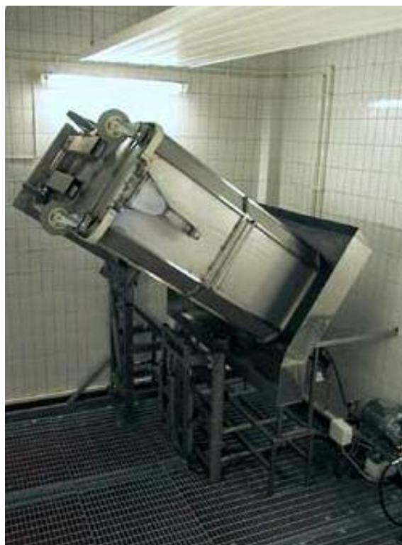
Kombinerad kärl och vagnsvätt, Kalmar Länessjukhus.
